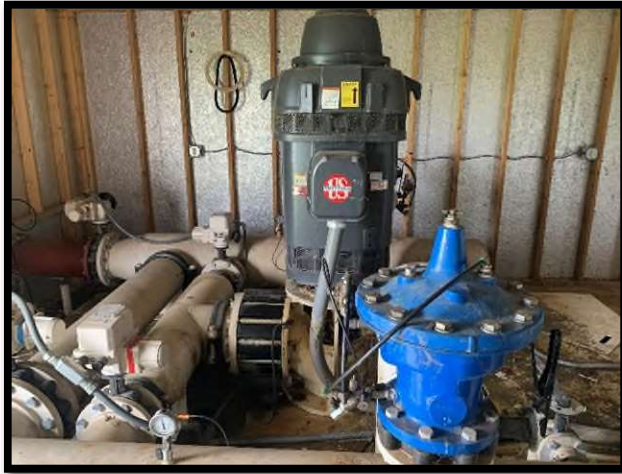
West Milavec Pump Skid
